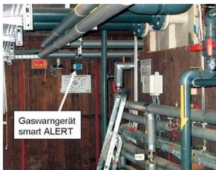
Bild 7: Gaswarnanlage in einer landwirtschaftlichen Biogasanlage (Landwirtschaftszentrum Haus Düsse der Landwirtschaftskammer NRW) außerhalb der Zone 2
